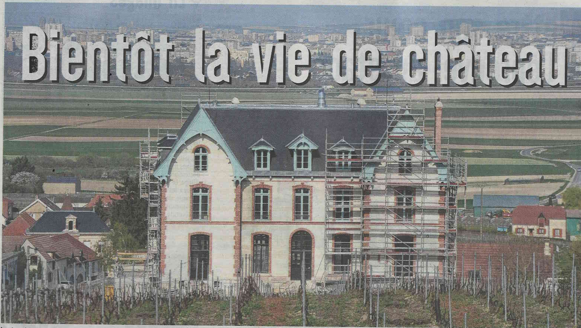
La toiture désormais terminée, une semaine sera nécessaire pour démonter l'échafaudage qui entoure l'immense bâtisse de 1 100 m 2 sur quatre niveaux. Remi Wafflart
