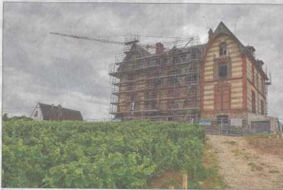
Équipée de ses échafaudages, l'ancienne « villa Maria » attend désormais l'équipe de rénovation. Hervé Quin
